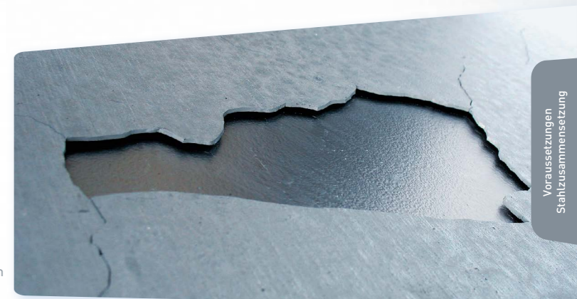
Beispiel für Abplatzungen auf Grund von zu hohen NTV-Zinkschichtdicken
