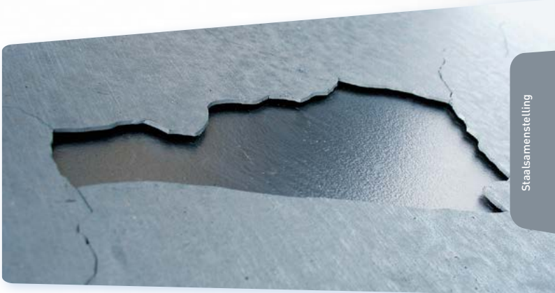
Voorbeeld van een gebarsten zinklaag door een te grote laagdikte.
