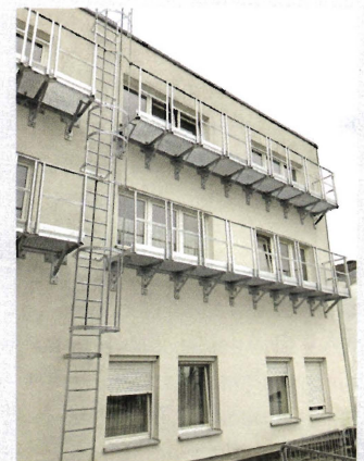
Steigleitern ermöglichen im Notfall das unbeschadete Verlassen eines Gebäudes über die Fassade, wenn die Rettungswege innen versperrt sind.
